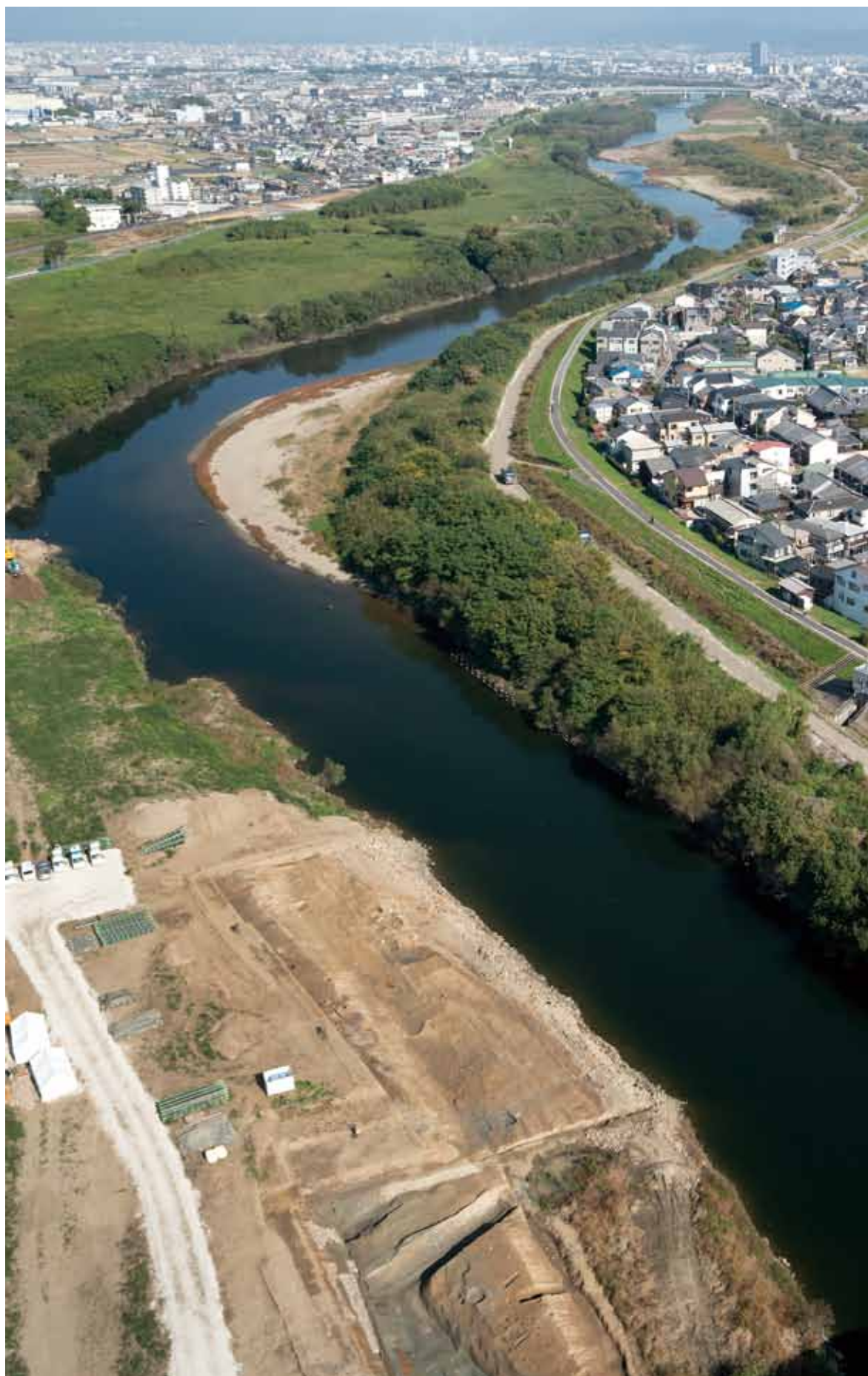
調査地全景（南南西から）
