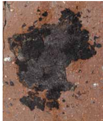
漆による補修跡（写真2の外内面）
